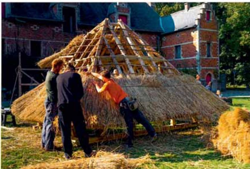
Het MOT bouwde een vakwerk-kerststal om de technieken van vakwerkbouw en het strodekken te kunnen documenteren en doorgeven [foto MOT Grimbergen]
